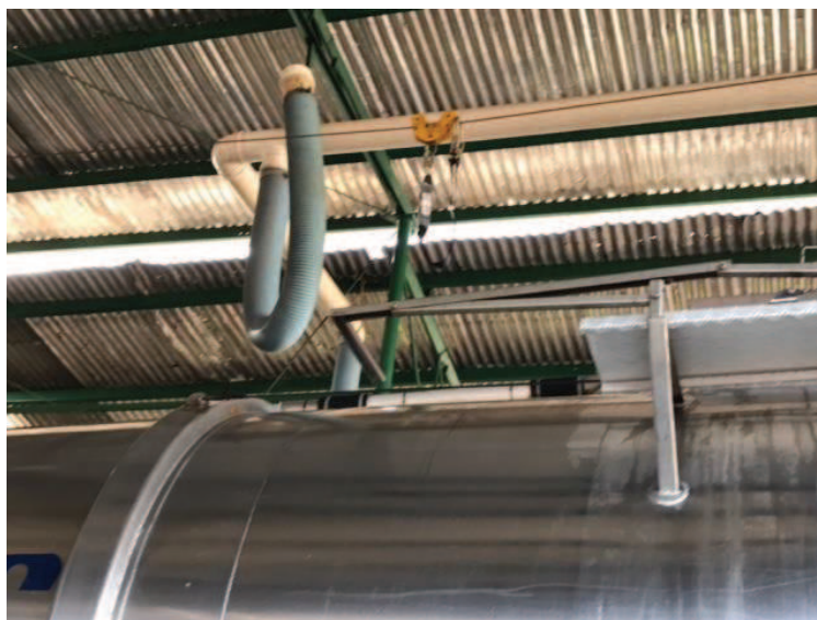
Figura 5 – Acoplamento do duto de ventilação forçada
