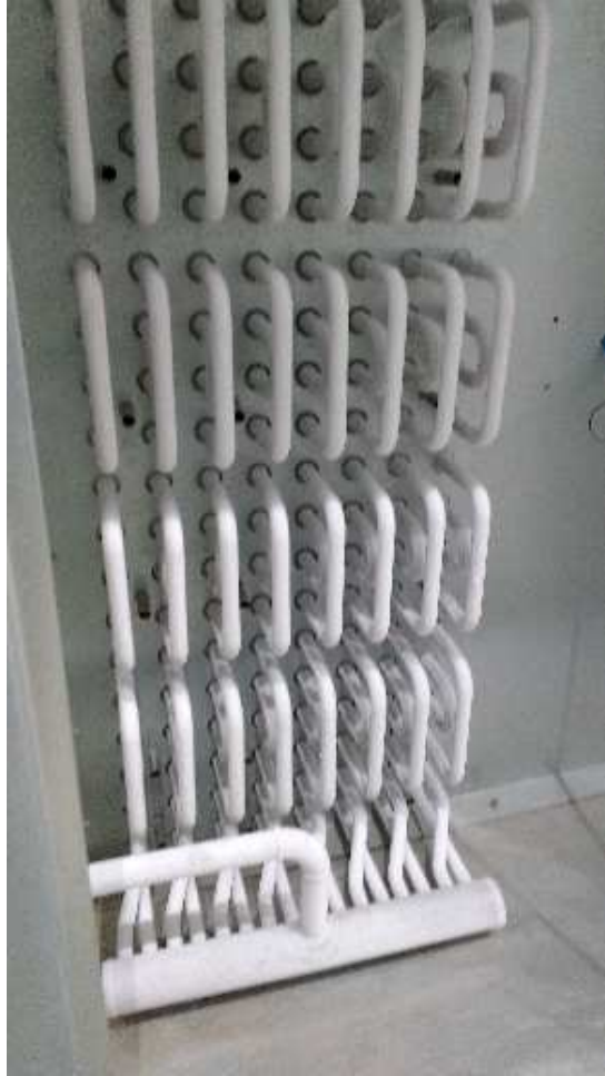
Figura 4.7 – Formação de geada nos tubos do evaporador.
