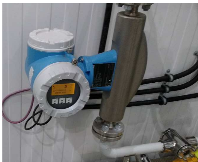
Figura 3.4 – Localização e posicionamento do transmissor de taxa de massa na entrada do evaporador.
