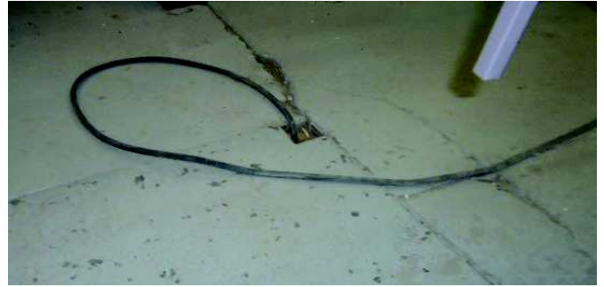
Figura 11 – Instalações elétricas (antes).
