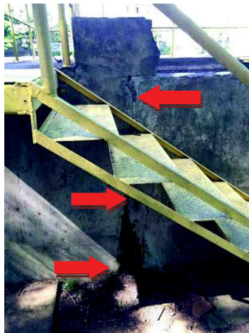
Figura 14: avançado processo fissuratório por falta de manutenção
