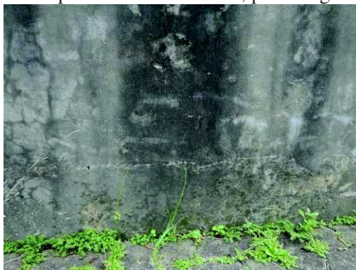
Figura 9: mapeamento da estrutura, por secagem rápida
