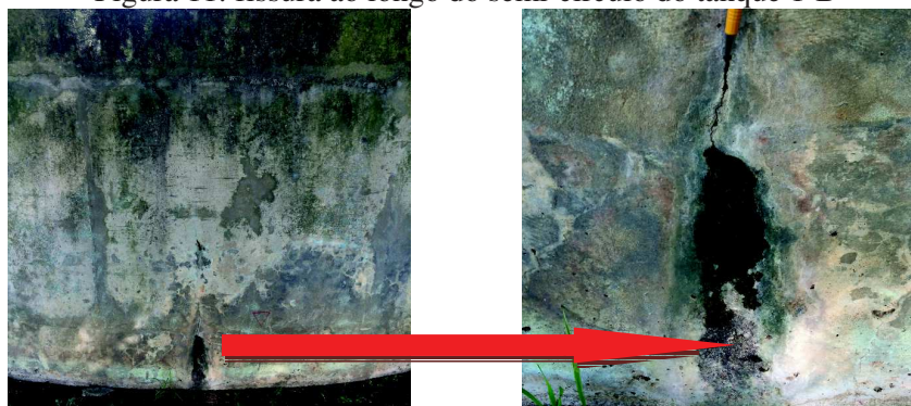
Figura 11: fissura ao longo do semi-círculo do tanque 1-B
