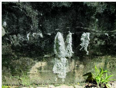
Figura 8: presença de eflorescência na estrutura do tanque 1-B
