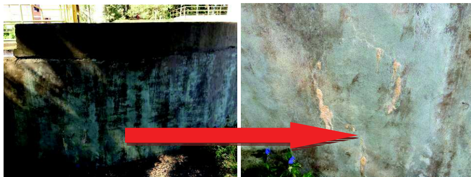
Figura 13: formação de eflorescência em antiga travessia de tubulação
