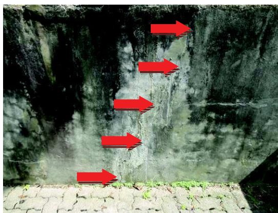
Figura 10: fissuras inclinadas, evidenciando sobrecarga
