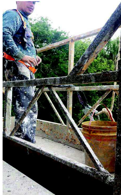
Fotografia 04 – Andaime em condições precárias (O.4)
