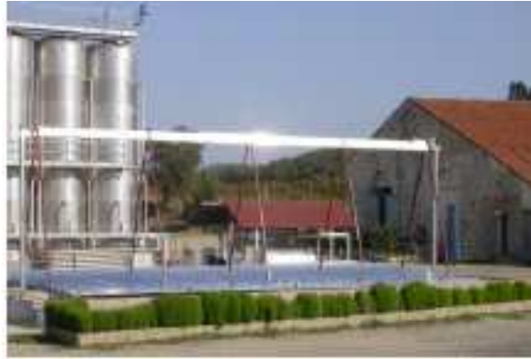
Figura 3.2 – Foto do sistema de coletores instalado em uma fábrica de bebidas na Tunísia.
