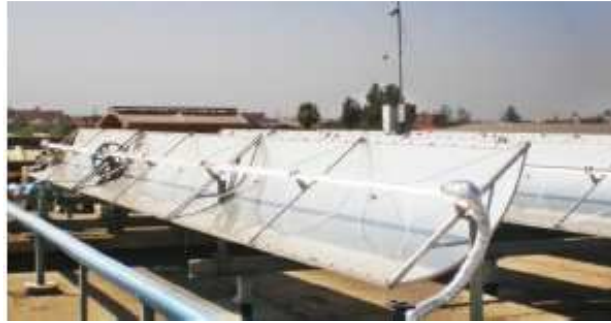
Figura 3.3 – Foto do sistema de coletores instalado em uma fábrica de laticínios no Marrocos.
