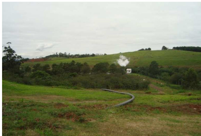
Figura 6: Dreno de coleta de lixiviado
