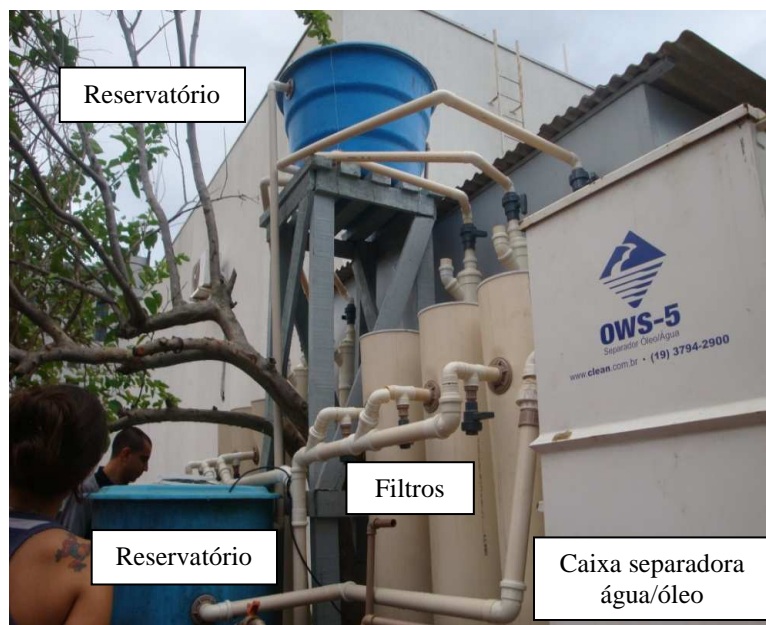
Figura 3 - Sistemas de remediação de áreas contaminadas por hidrocarbonetos utilizando filtros para adsorção composto por recheio de CCA e CA, da Empresa Projeconsult Engenharia Ltda.
