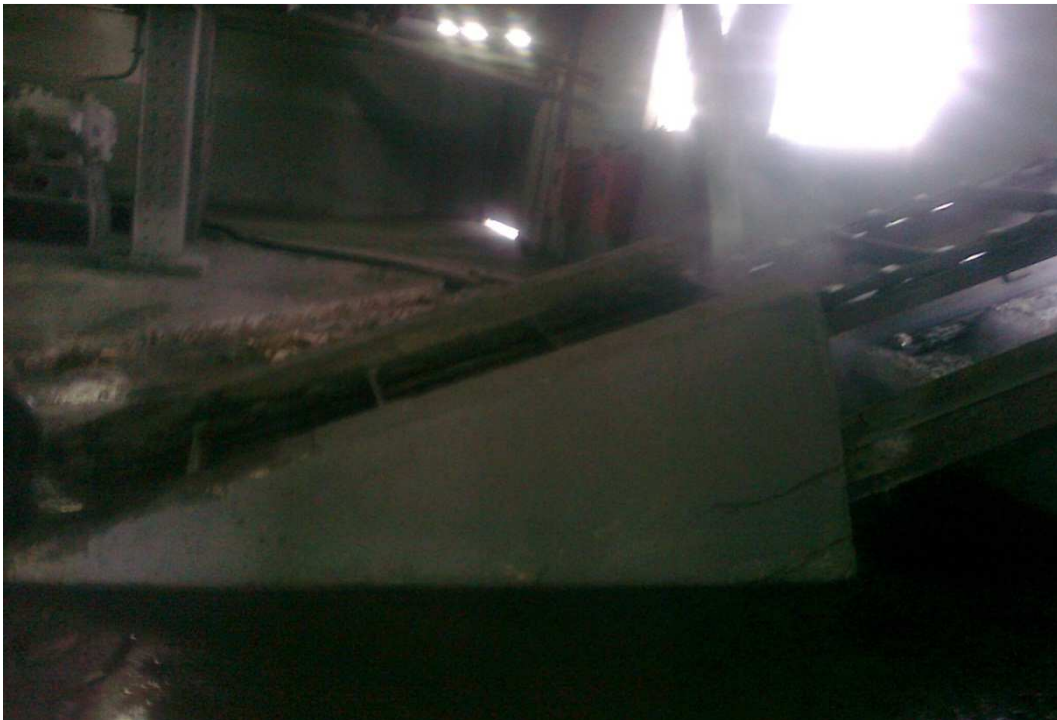
Figura 48 - Vista da entrada da caldeira em grelha do tipo móvel, carvão mineral
