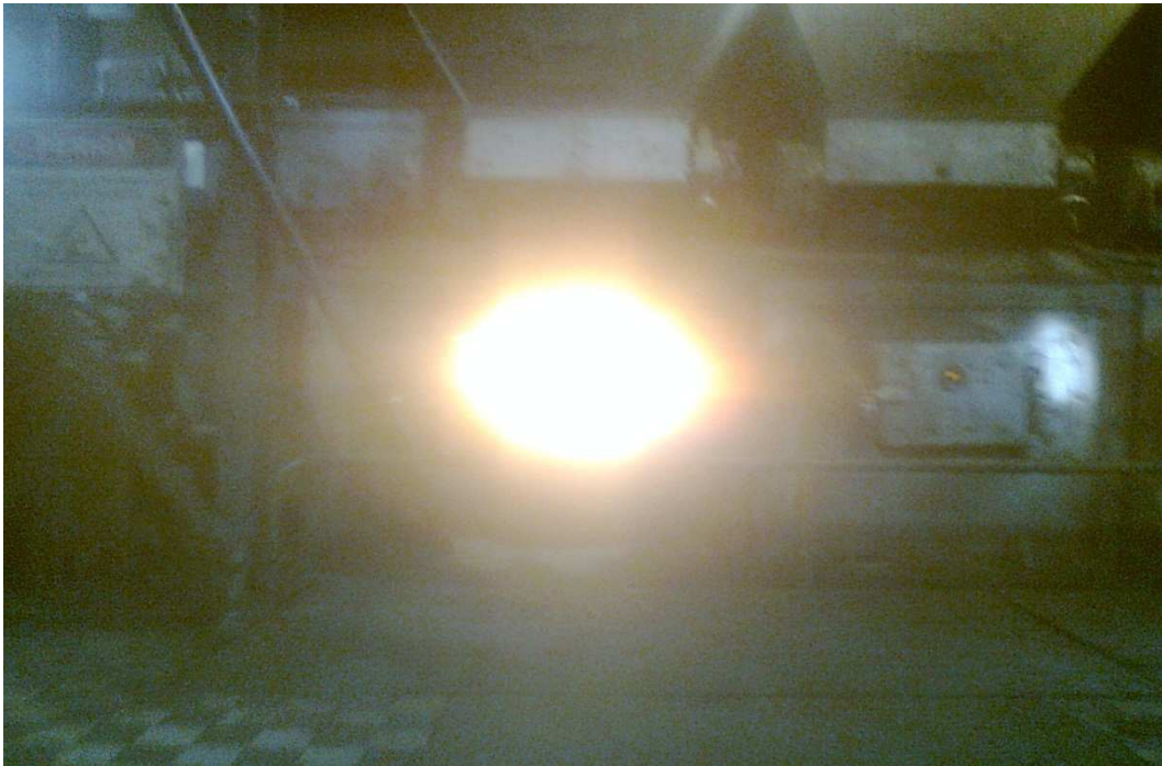
Figura 50 - Vista da caldeira em processo de queima (2)
