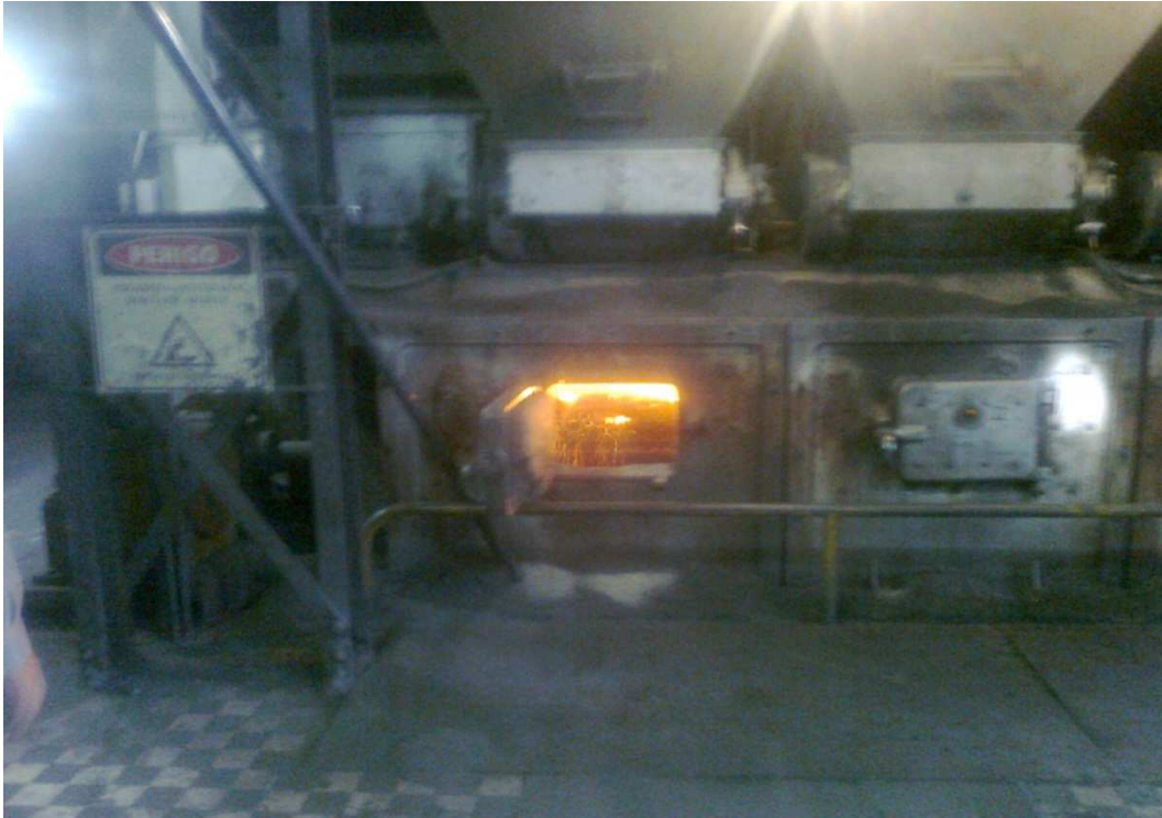
Figura 49 - Vista da caldeira em processo de queima (1)
