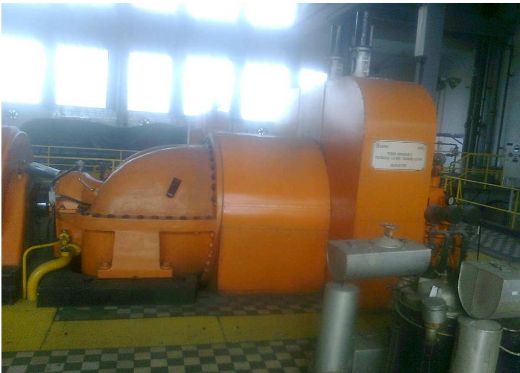
Figura 52 - Vista do gerador de potência
