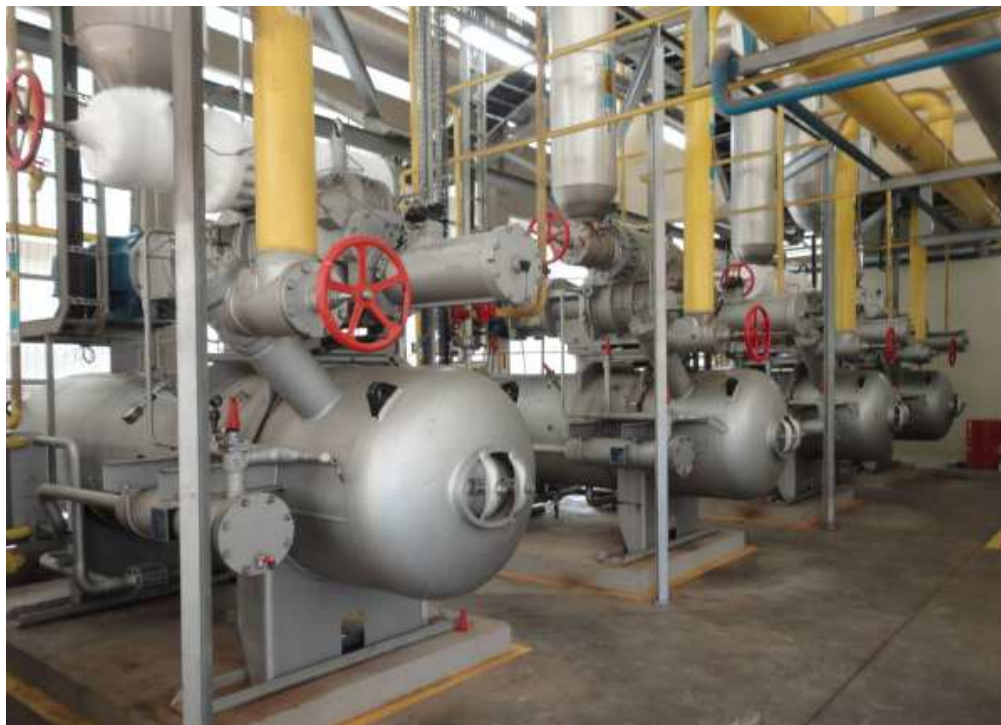
Figura 5.4: Imagem dos compressores do sistema de refrigeração
