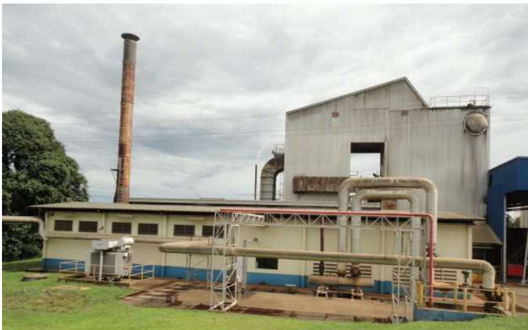
Figura 5.1: Imagem geral da caldeira em análise
