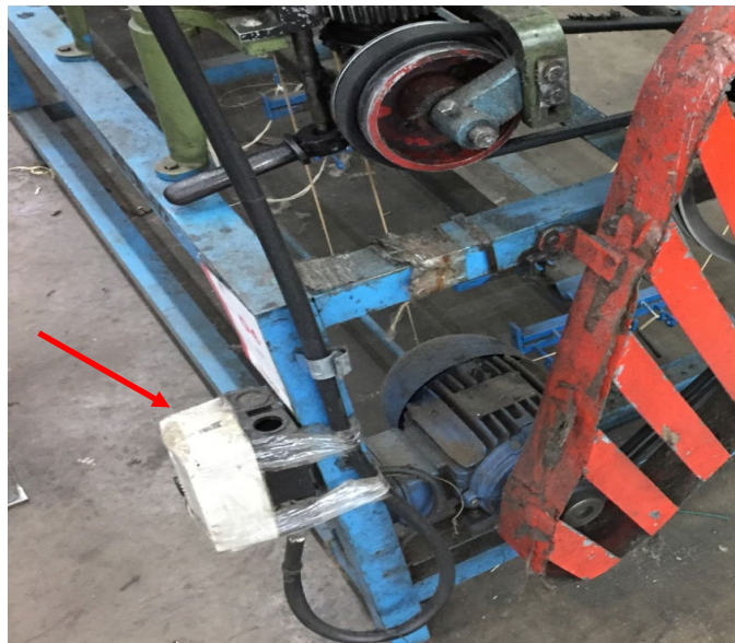
Figura 6 – Caixa elétrica constante no equipamento.
