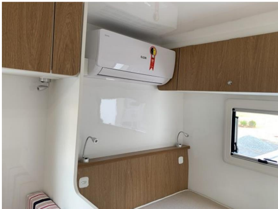
Figura 7 – Trailer Apolo com ar condicionado split
