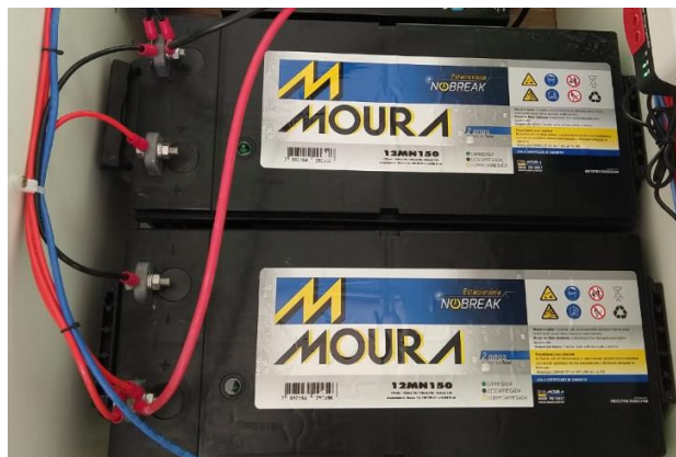
Figura 5 – Banco com duas baterias estacionárias instalado em um trailer
