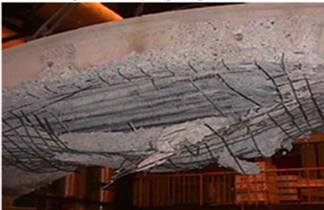
Figura 9 – Efeito spalling em viga de concreto
