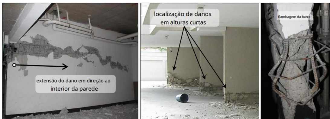
Figura 8 – Deformações em pilares-parede no Chile, ocasionado por sismo
