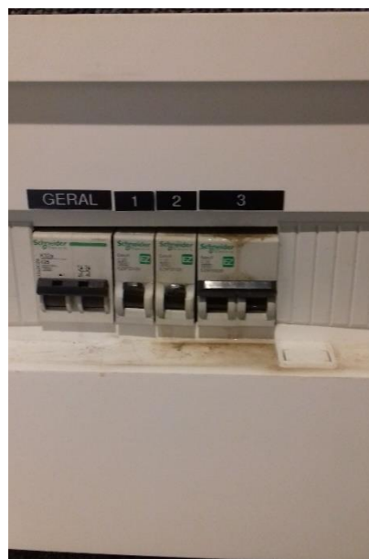
Item 17 – Entrada de água no quadro de disjuntores
