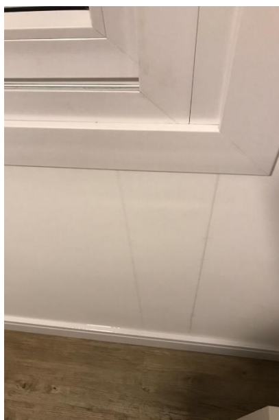
Item 42 – Entrada de água abaixo da janela
