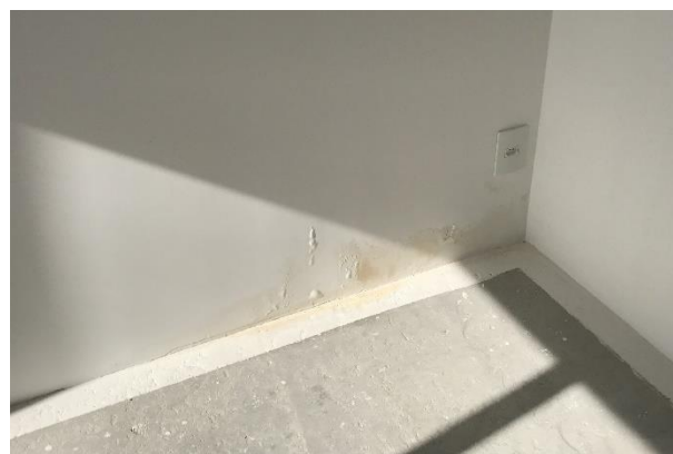
Item 46 – Desagregação do revestimento
