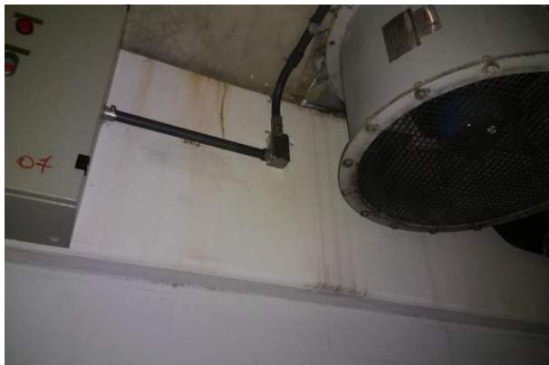
Item 98 – Entrada de água acima da viga
