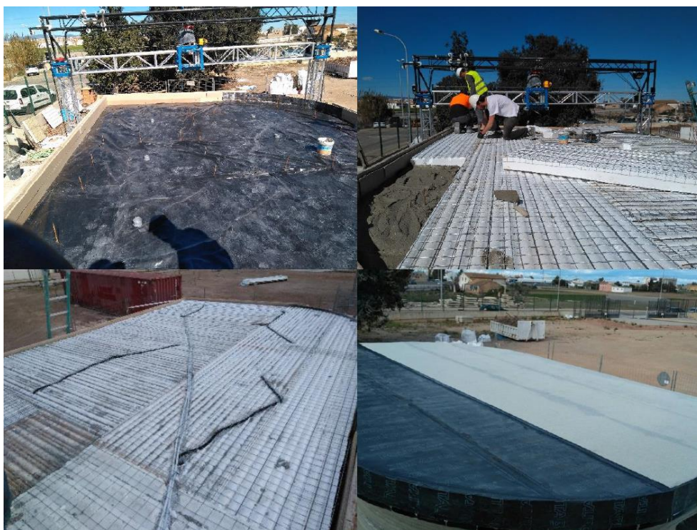
Fotografia 25 - Instalações elétricas e hidráulicas da 3D Housing
