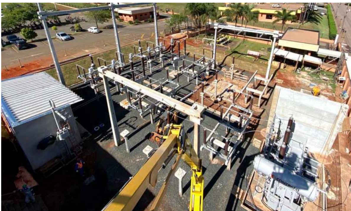
Figura 7 - Subestação convencional em Cordeirópolis/SP
