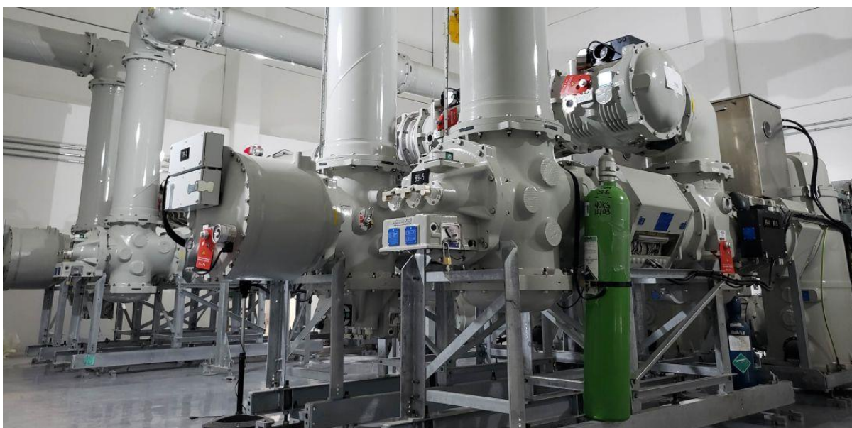
Figura 8 – Subestação GIS em Porto Alegre/RS
