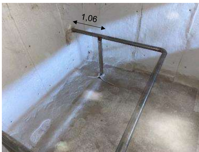
Fotografia 3 – Distância dos furos do queimador a partir da parede de fundos
