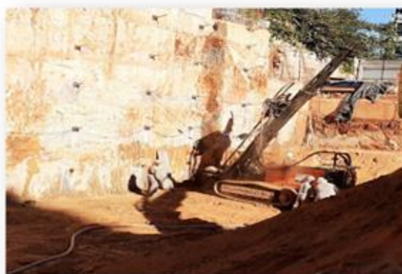
Perfuração do trecho D, 5ª linha de tirante, com perfuratriz e ar comprimido.
