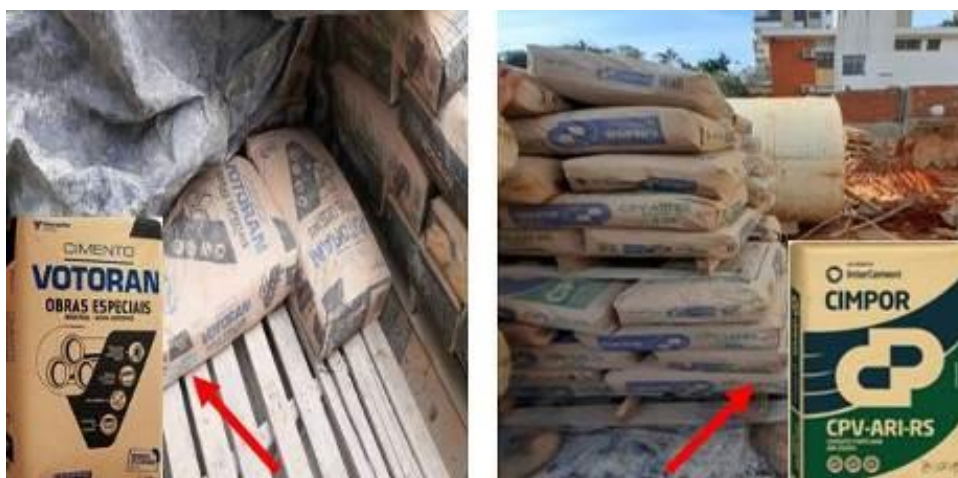
Fotografia 34 - Cimento utilizado nas injeções das obras A e B, respectivamente
