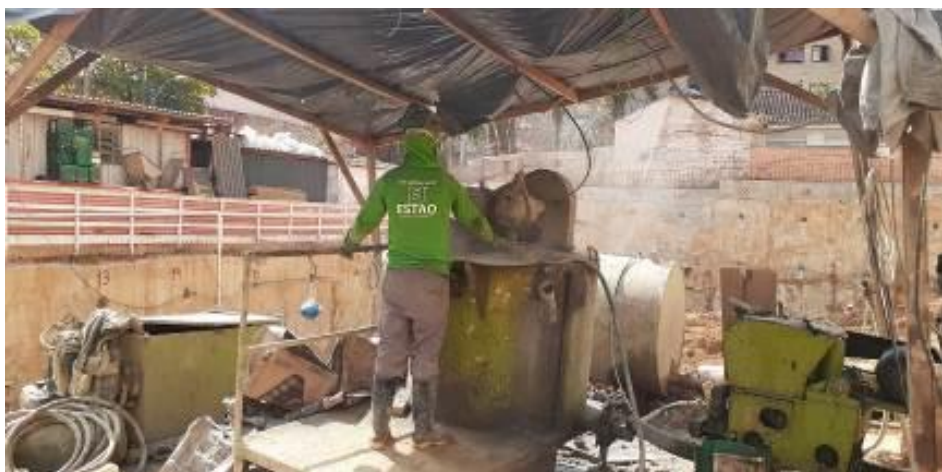
Fotografia 29 - Misturadores de calda da obra A
