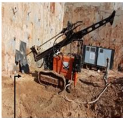
Perfuração dos tirantes trecho C, 4ª linha, com uso da perfuratriz e compressão de ar.
