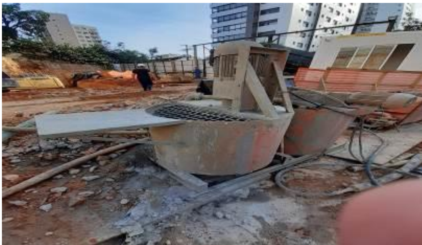
Fotografia 30 - Misturadores de calda obra B
