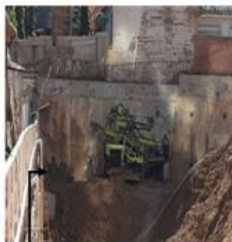
Perfuração do trecho B1, linha C, com uso de perfuratriz e ar comprimido.
