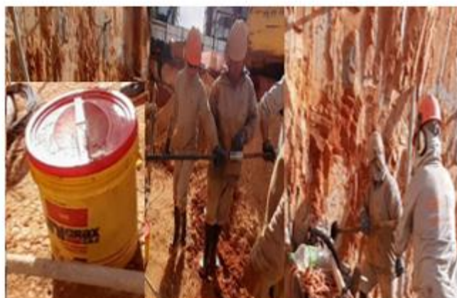
Preparação do tirante trecho D, 4ª linha com uso de graxa como proteção contra corrosão e espaçadores a cada 2 m, colocação do tirante no furo.
