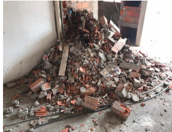
Figura 16 – Acondicionamento inicial inadequado
