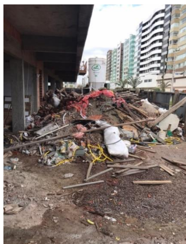
Figura 13 – Acondicionamento final inadequado
