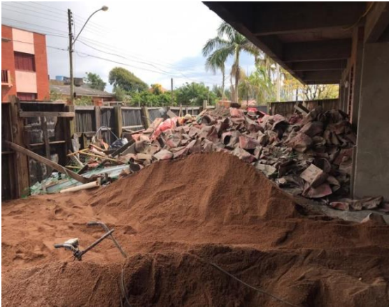
Figura 15 – Ausência de triagem dos resíduos
