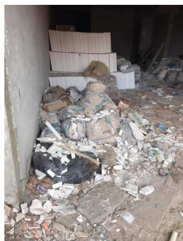
Figura 20 – Acondicionamento final inadequado
