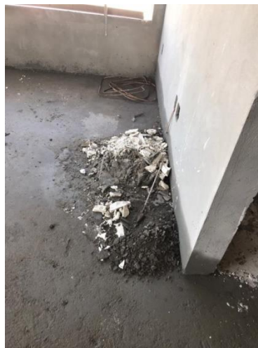
Figura 32 – Ausência de triagem dos resíduos
