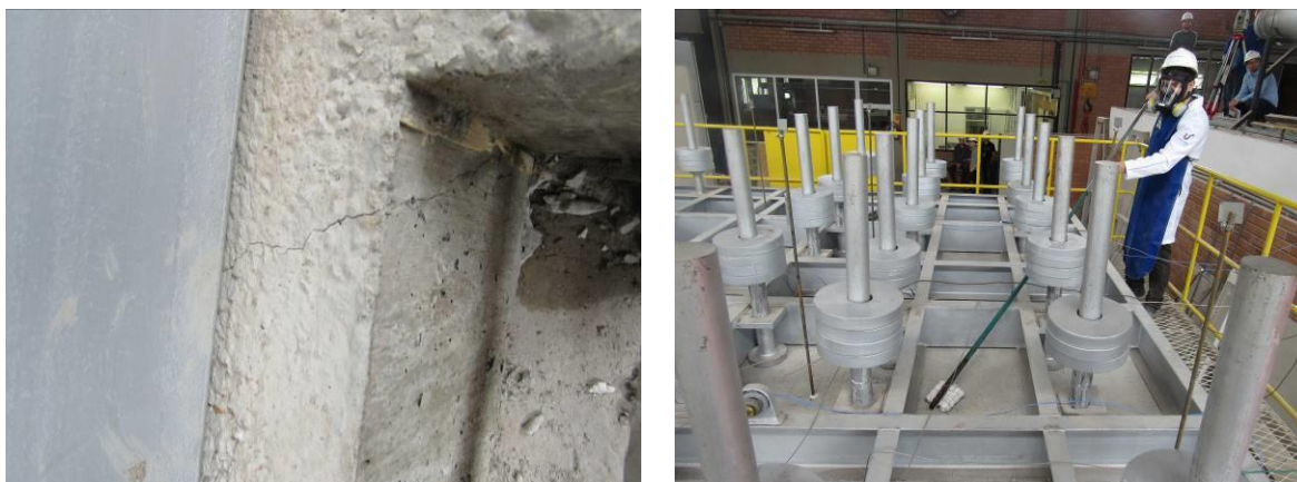
Figura 51 – (a) Configuração da fissura e (b) teste de estanqueidade
