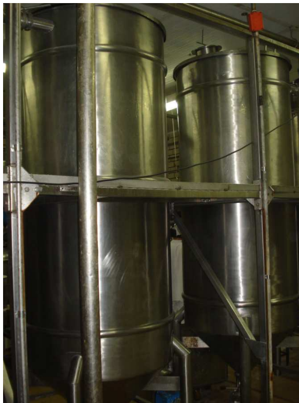
FIGURA 08: Silos de Armazenamento.
