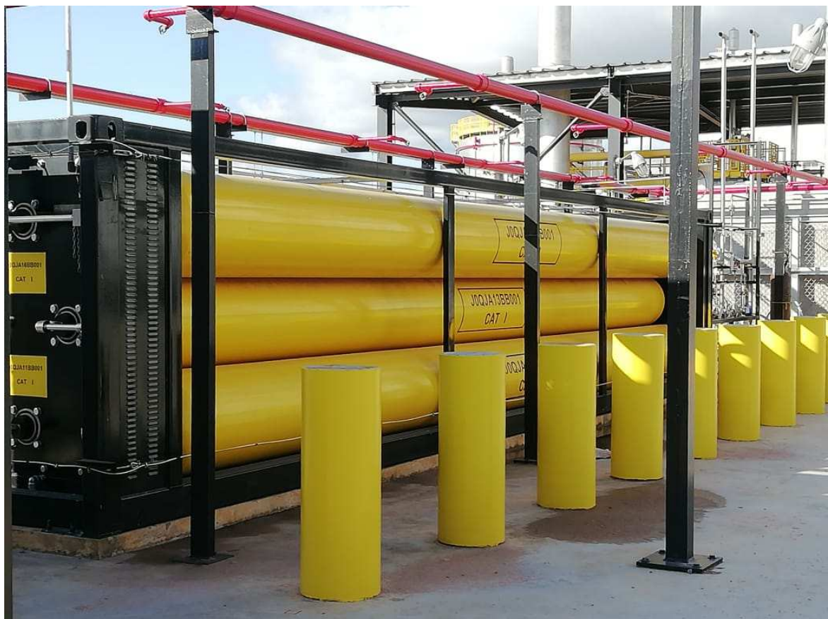
Figura 1 – Instalação dos Manifold com os vasos de pressão
