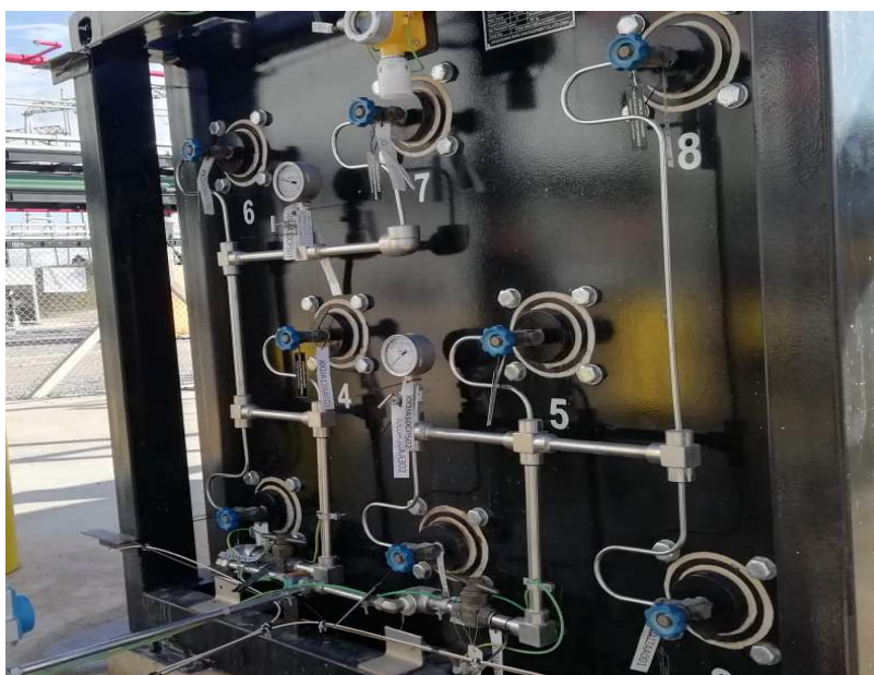
Figura 3 – Manômetros instalado no equipamento
