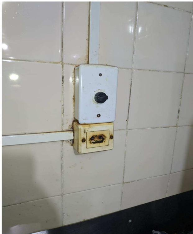
Figura 7 – Tomada em mau estado
