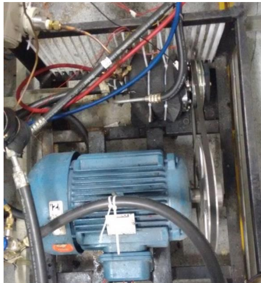
Figura 3.9: Compressor e motor elétrico para seu acionamento.
