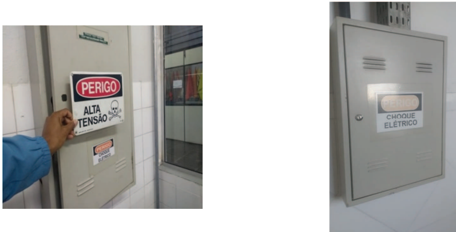
Figura 6 – Caixa de disjuntores aberta e placa de perigo descolada
