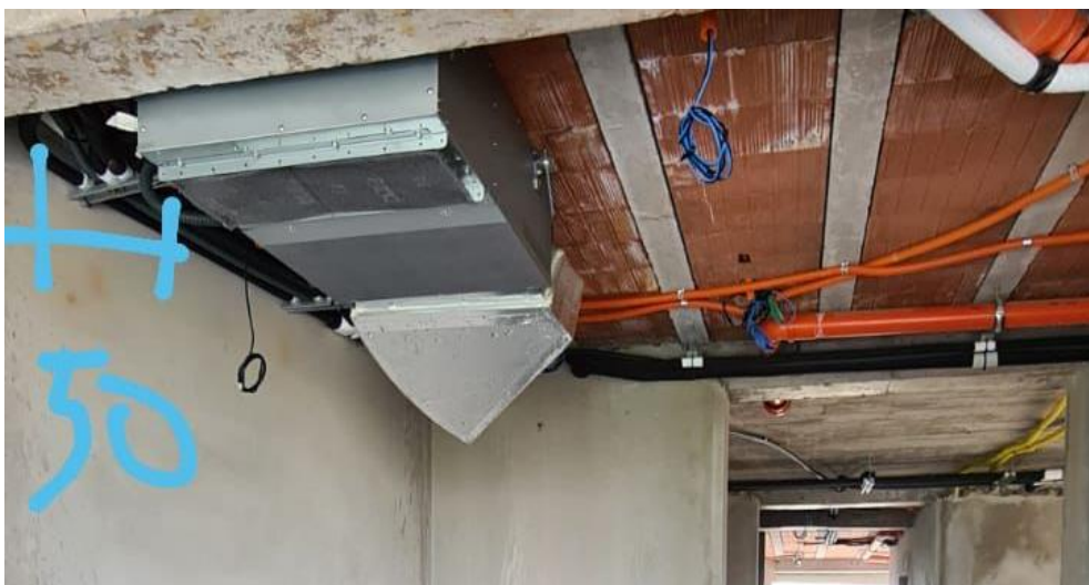
Figura 8– Sistema de ar-condicionado
