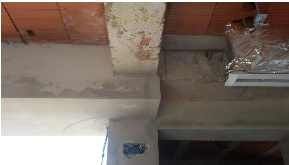
Figura 36– Interferência entre Executivo e Estrutural
