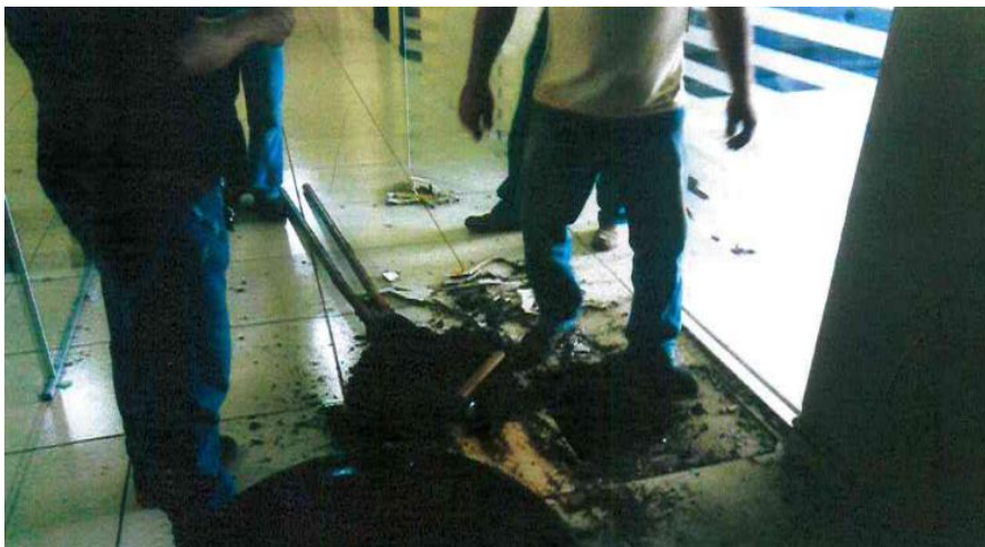
Figura 7 – Tentativa de fuga da cadeia pública de Ivaiporã/PR (03/02/2017) – Área administrativa da delegacia danificada em virtude do túnel escavado pelos presos
