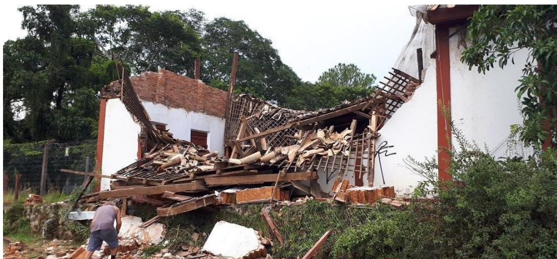
Figura 7 - Desabamento de parte da Casa da Feitoria - Museu do Imigrante
